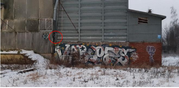
Kuva 11. Öljysäiliön täyttöputki (viljakuivain).
