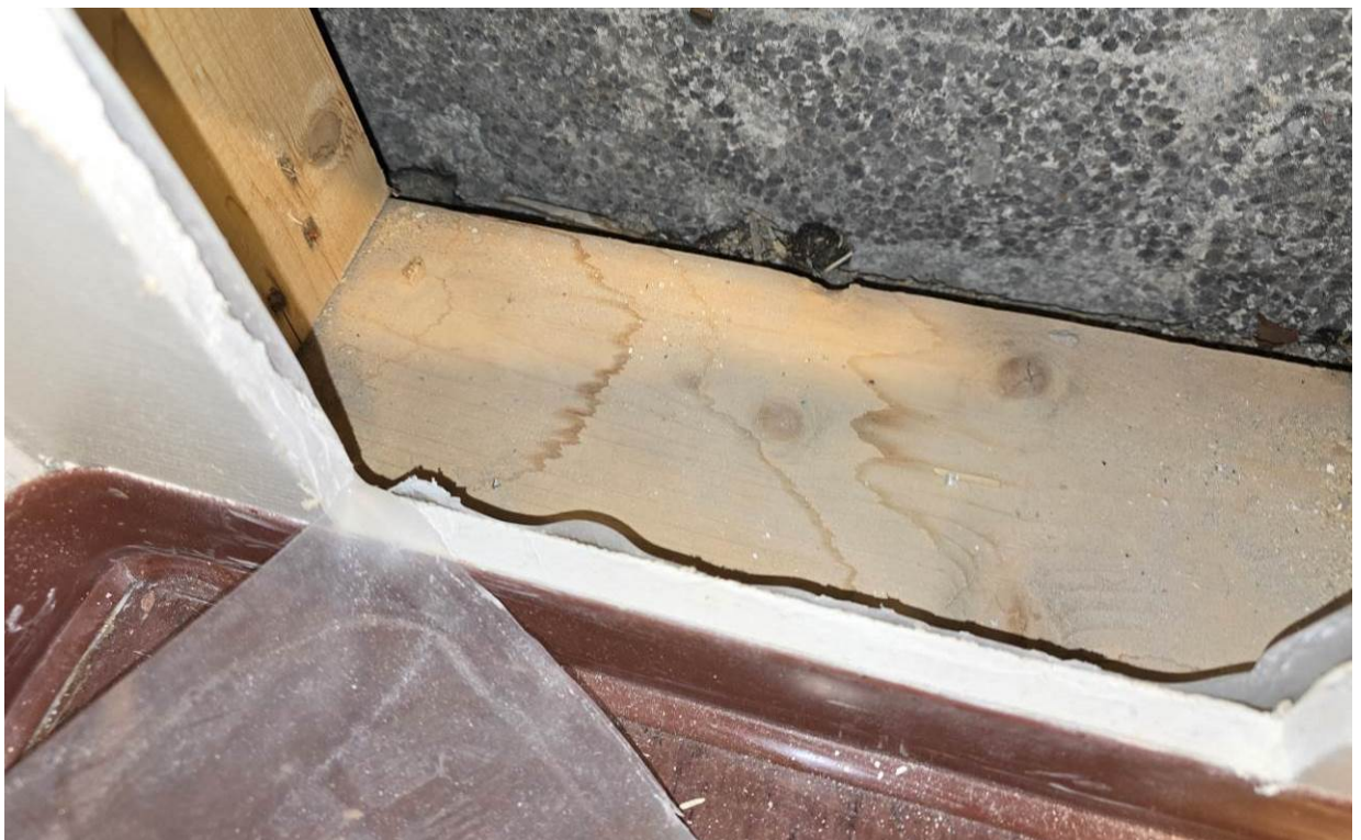
Alajuoksussa on havaittavissa vanhoja kosteusjälkiä
