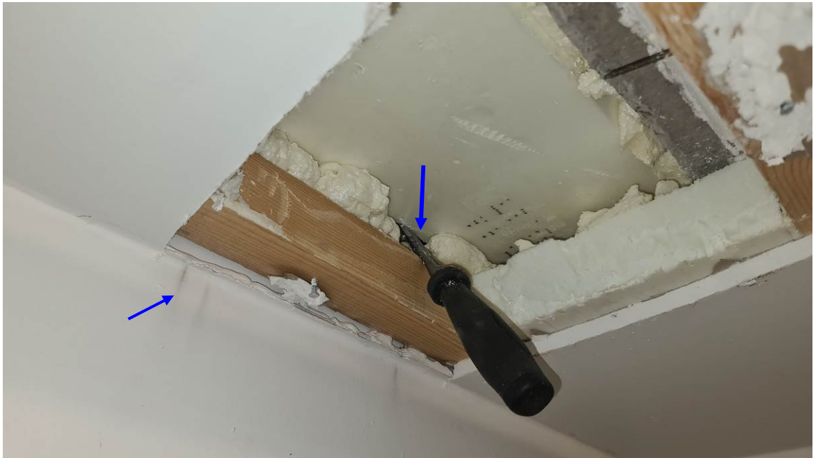
Ilmavuotokohtia, uretaanilevy tiivistetty vaahdolla (epätiivetyiskohtia)
