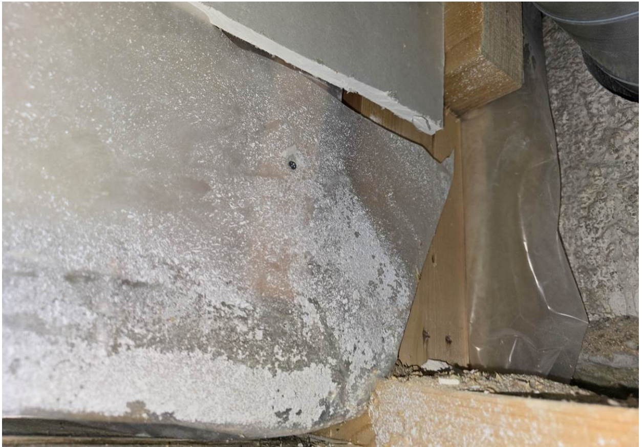
Liittymän lähellä poistettu seinälevytystä, höyrystulut ovat epätiiviiit
