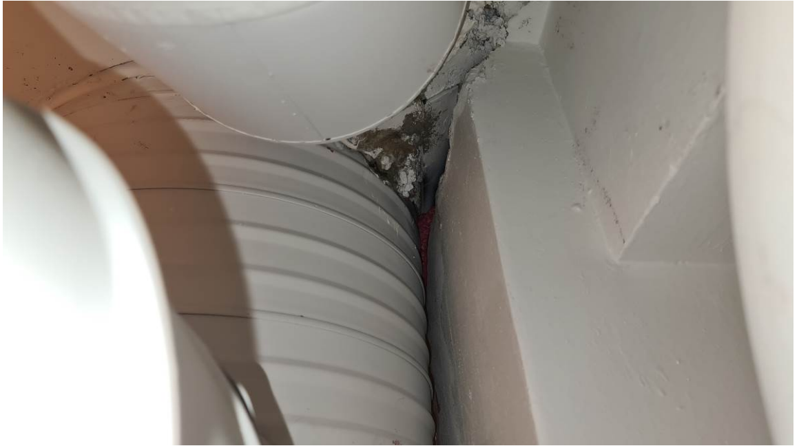
Poikien pukuhuoneen katossa iv-putken läpivienti epätiivis
