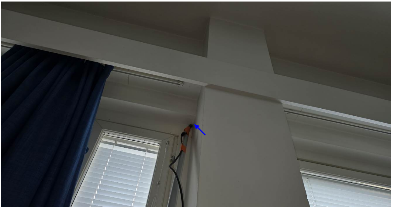
Ja ikkunan yläreunassa pilarin liittymässä
