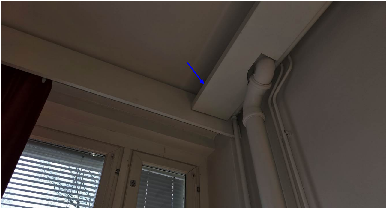
Oikeassa ylänurkassa kaapelihyllyn päällä vuotoa
