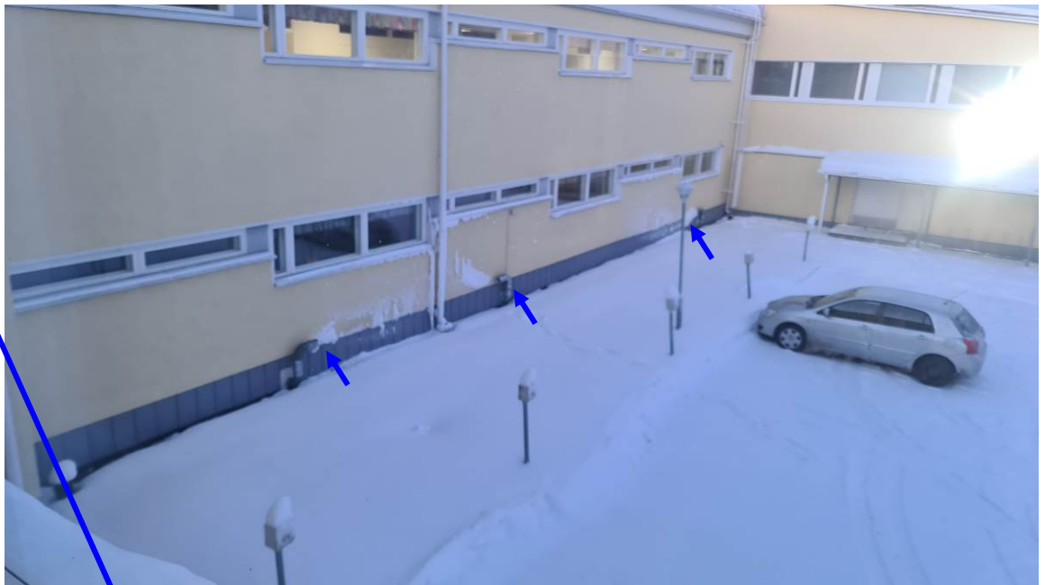
Ilmanvaihtokoneen ilmanotot, alapohjan tuuletustilasta tuleva ilma
