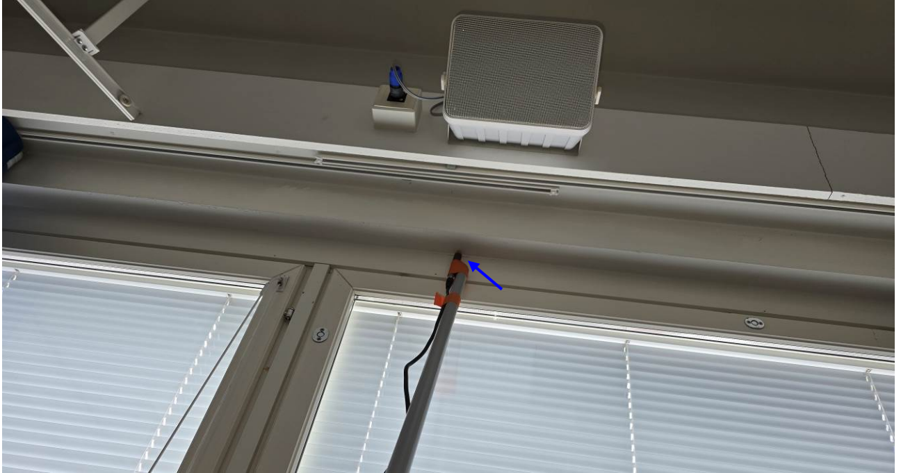
Pistemäinen vuoto ikkunan listan ja seinän liittymässä
