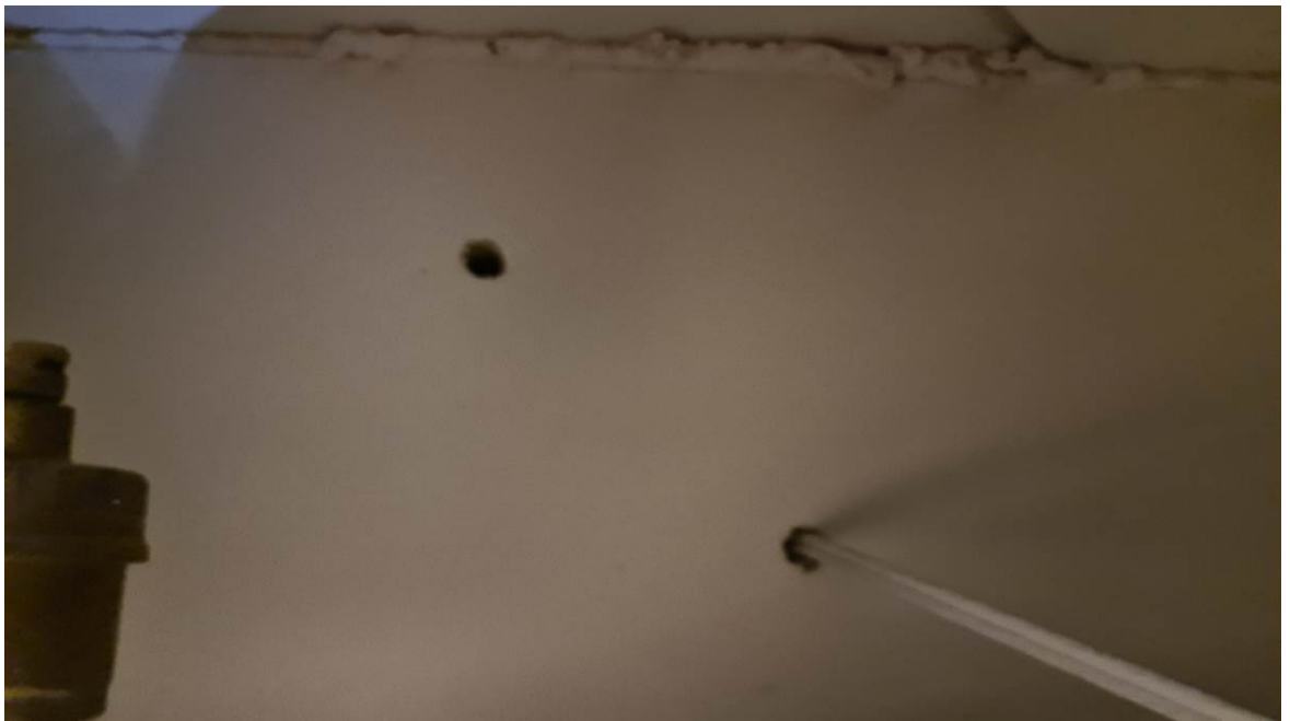
Ulko-oven päällä uretaani levy, minkä liitos yläreunasta ontelolaattaan vuotaa ja levyssä reikiä.
