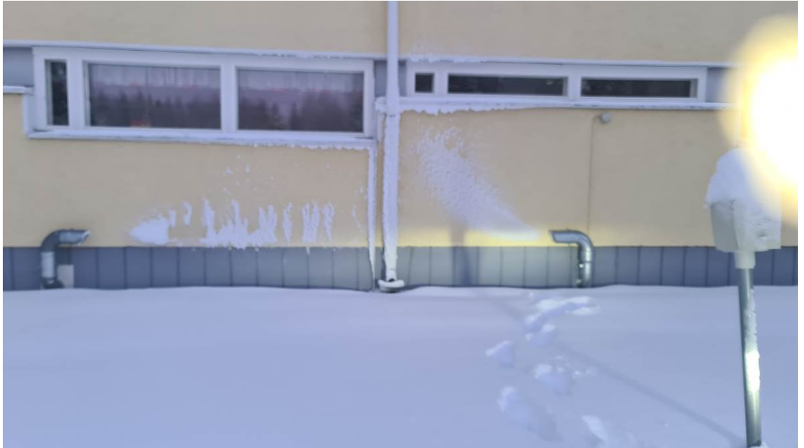
Ulkoseinä kuurassa mihin poisto puhalttaa alapohjasta.
