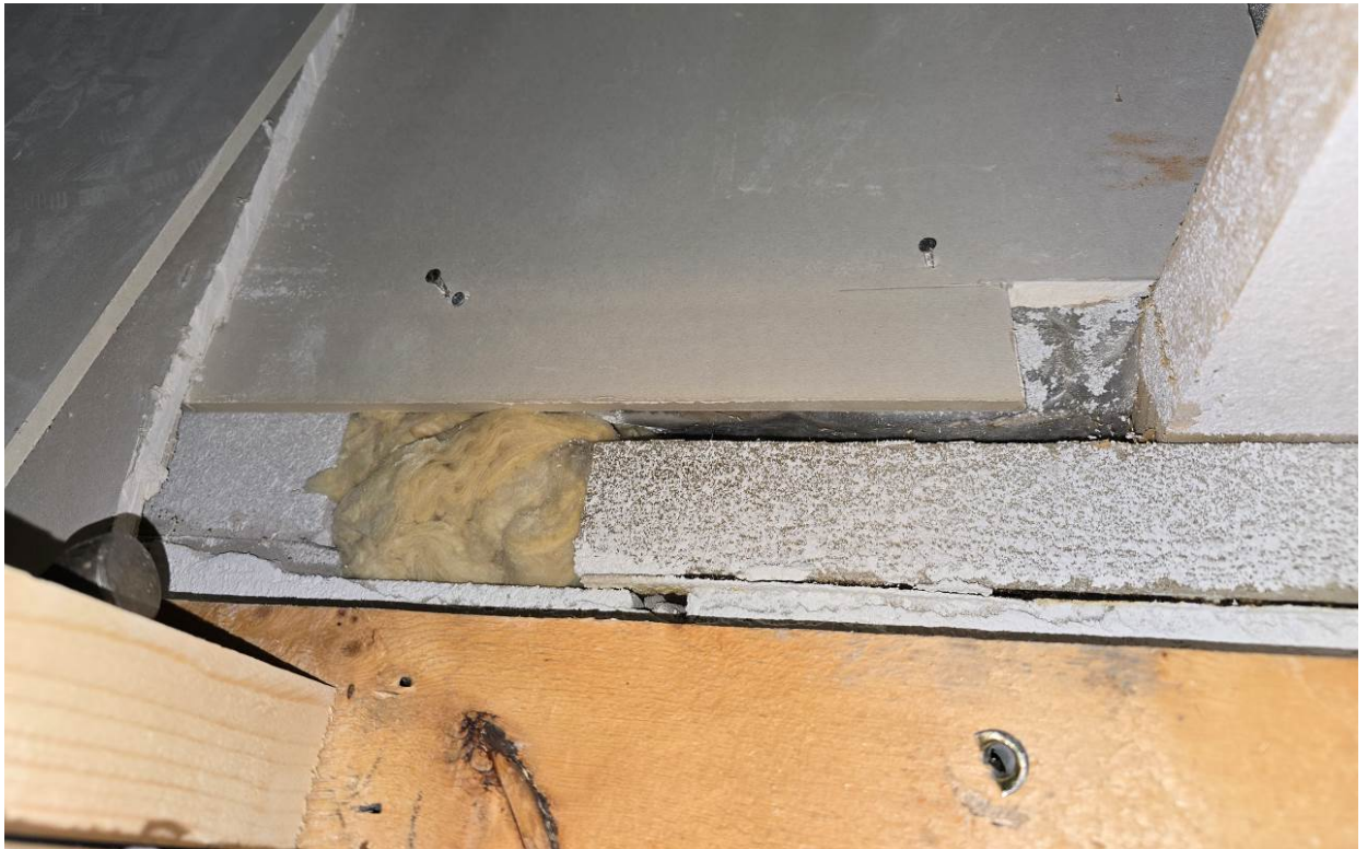
Alas laskussa yläosan liittymä tiili rakenteiseen alakertaan. on höyrysulun osalta epätiivis
