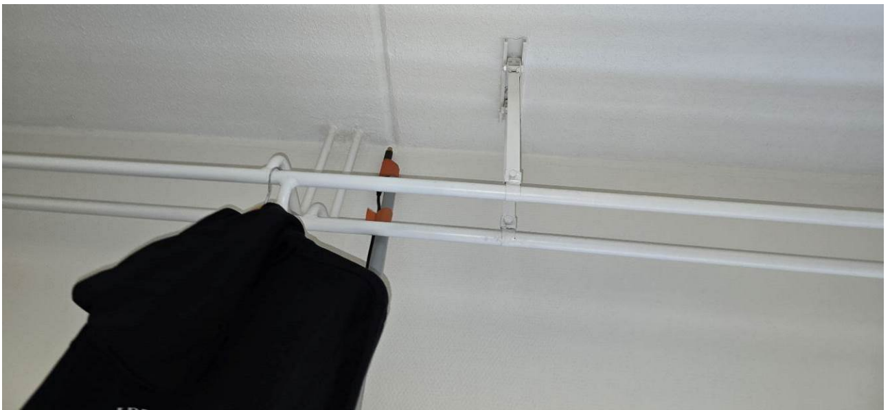
Samalla kohtaan katossa ontelon sauman kohdalla pistemäinen vuoto
