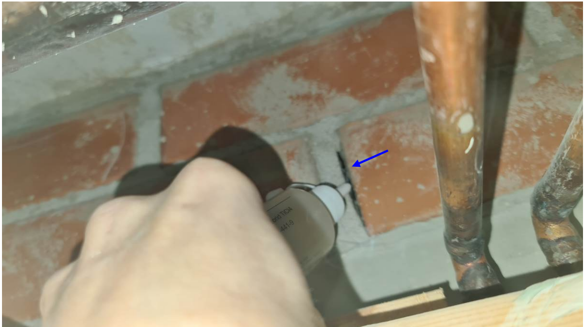
Pesuhuoneen kotelossa ulkoseinällä vuotoa rakenteesta
