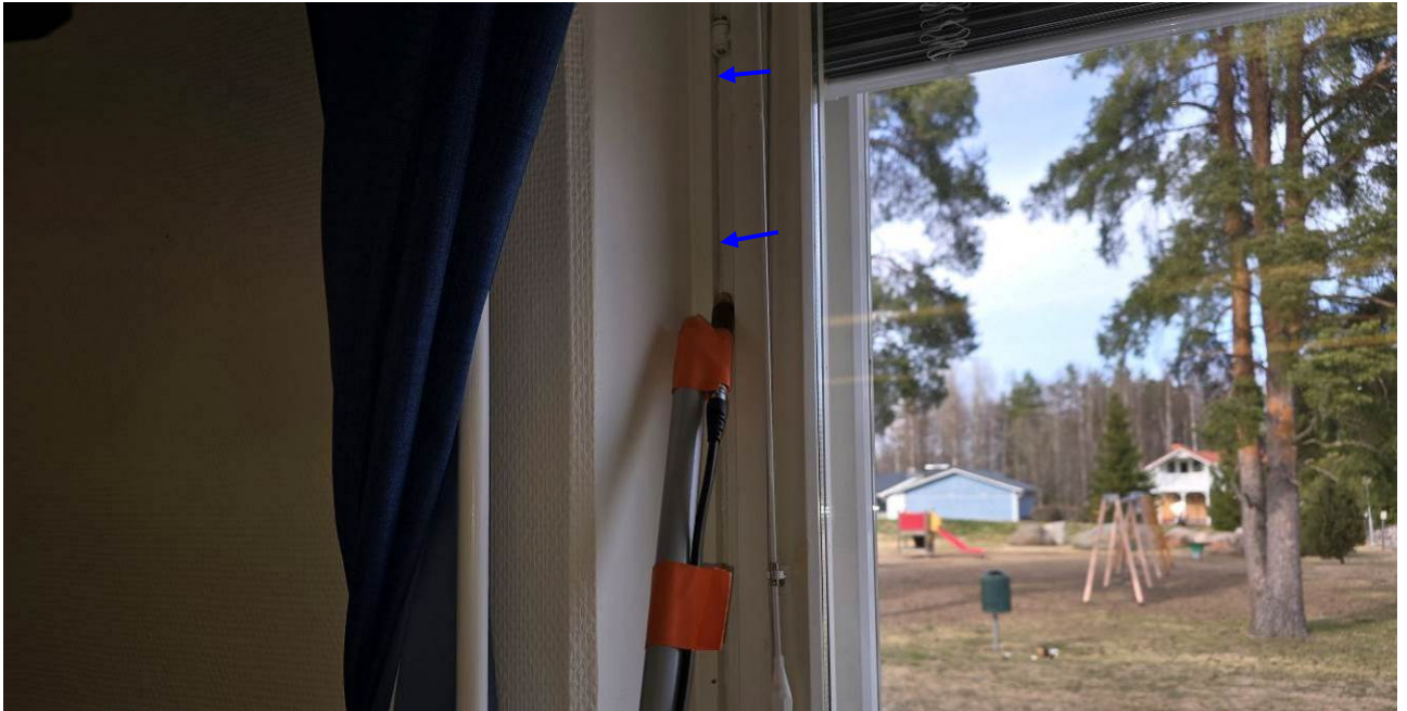
Vuotokohta karmin ja tiiviste nauhan liittymässä
