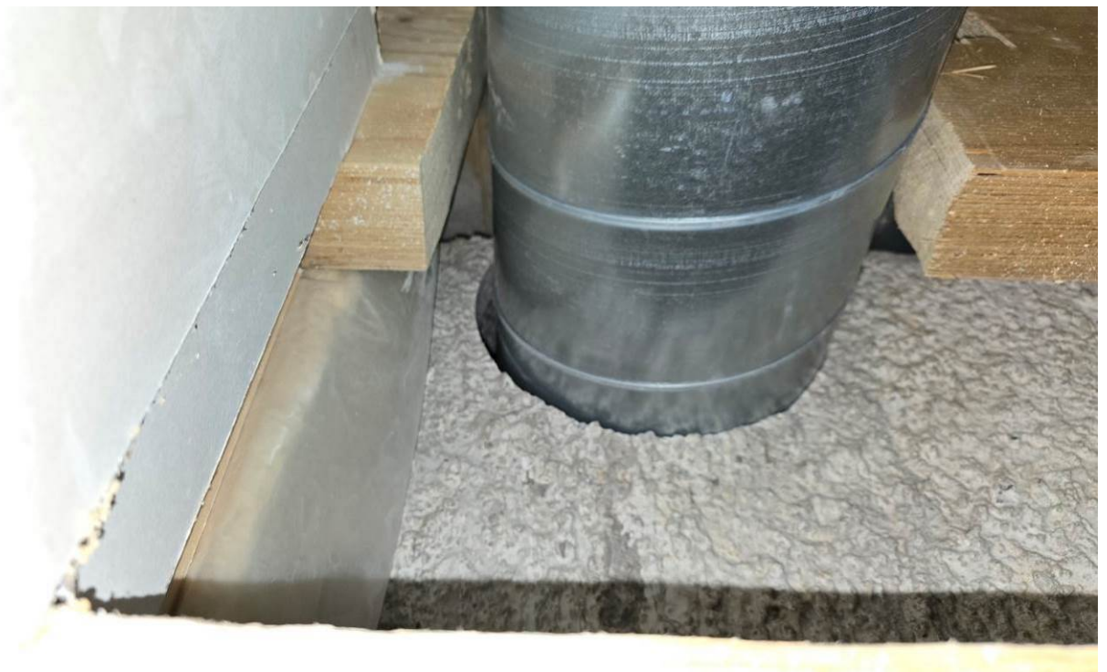
Alas laskutilaan jätetty vanha ulkoseinän harkko ja rappaus. Ulkoseinän höyrysulkua ei tiivistetty liittymässä
