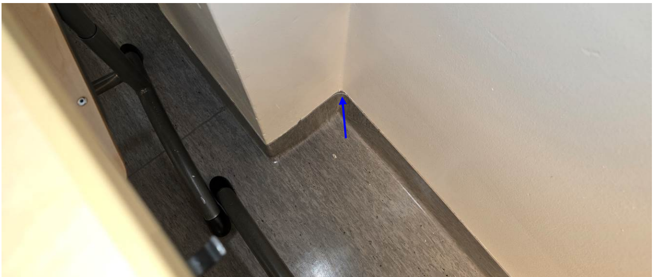
Pilarin oikeapuoli lattianrajassa lievää vuotoa
