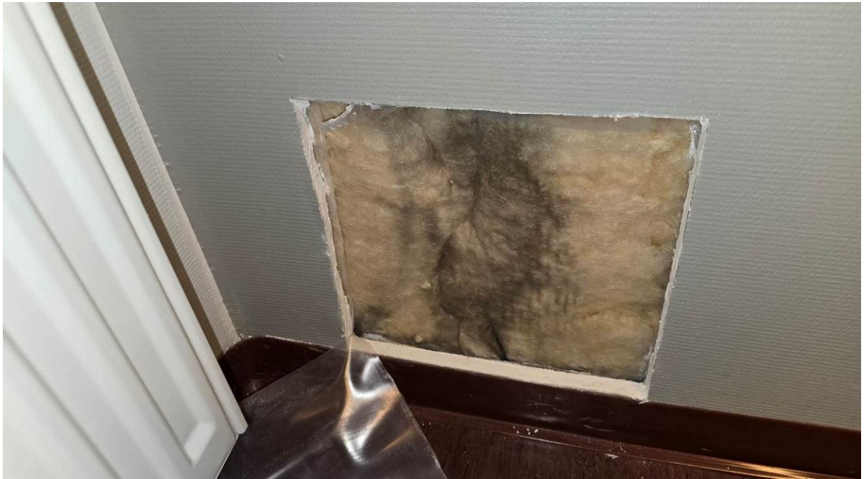
Rakenne avaus kohta, villassa tummentumaa minkä on aiheuttanut ilmavirtaukset. Villasta otettiin materiaalinäyte M4
