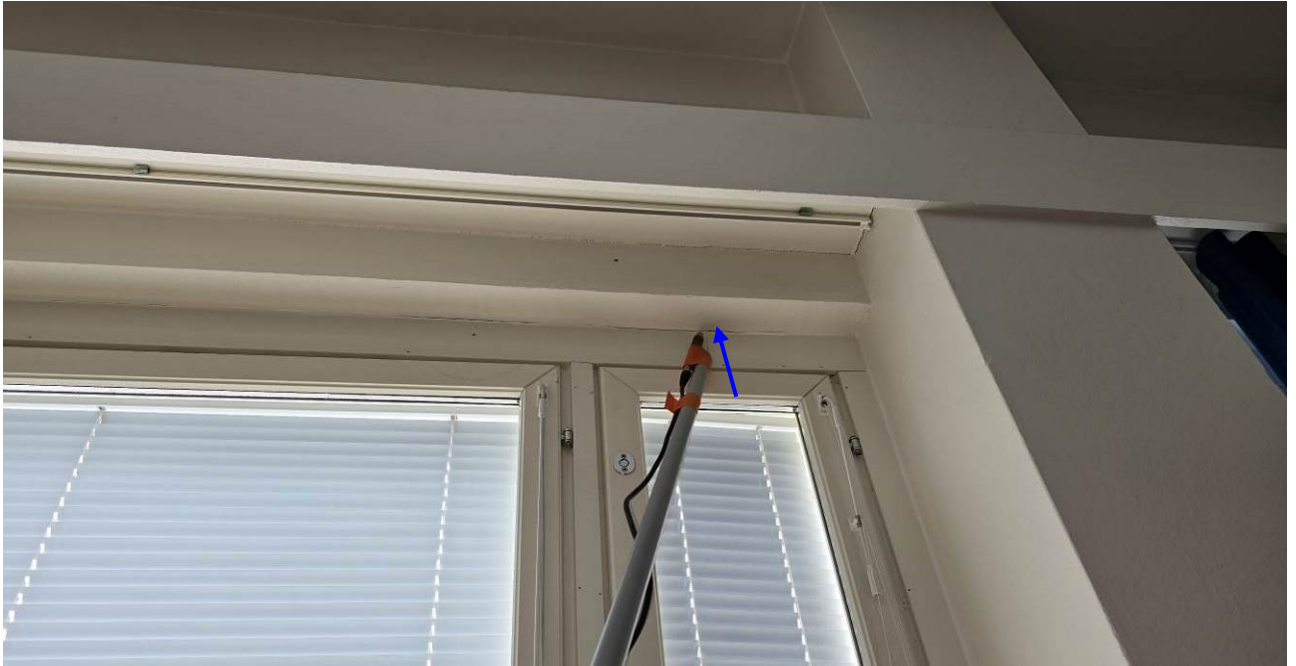
Lievää vuotoa ikkunalistan ja seinän liittymässä
