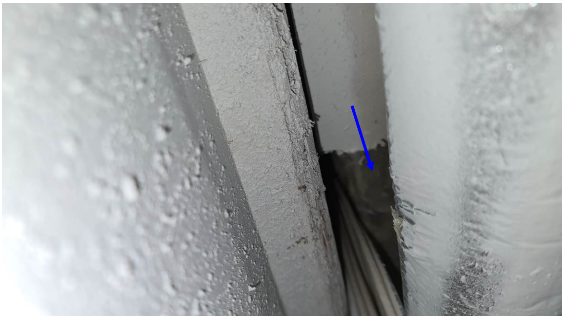
Rehtorin huoneessa sähköjohtojen läpiviennissä villoja näkyvillä
