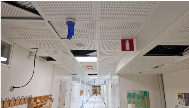
Poistoilmaventtiilit ja palohälyttimet tukittu.
