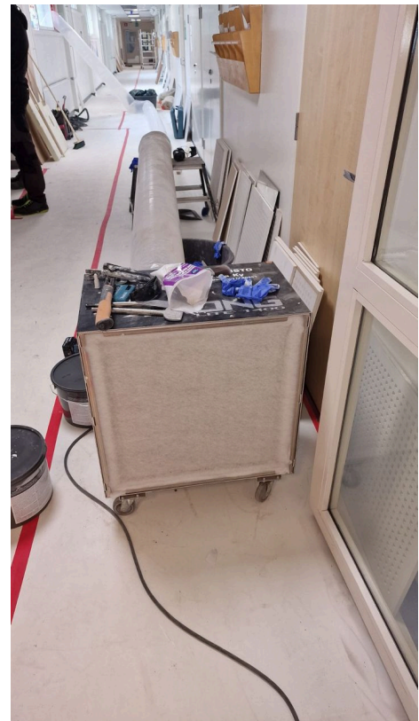
Alakerran käytävä alipaineistettu.
