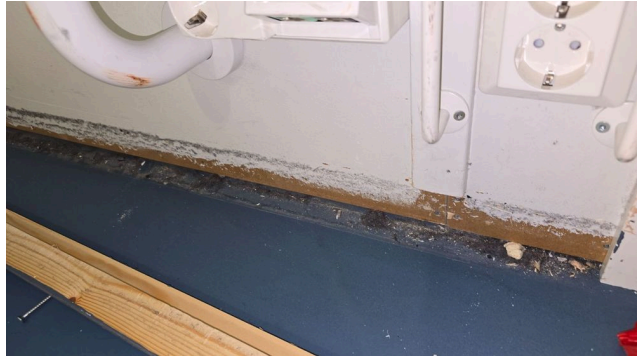
Liikuntasali joen puoli pääty seinää ei massattu. Seinässä levytys mikä olisi pitänyt aukaista, että tiivistys olisi saatu tehtyä.
