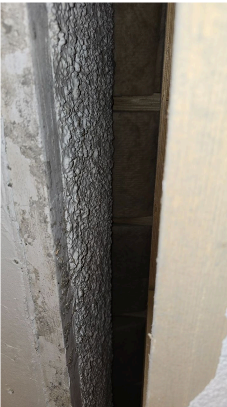
Vanha us rappaus ja välipohjassa villa auki
