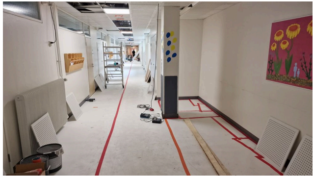
Alakerta. Poistoilmaventtiilit ja palohälyttimet tukittu.
