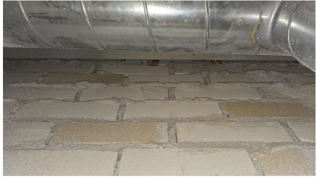
Vessojen kohdalla välipohjan liitos epätiivis seinään
