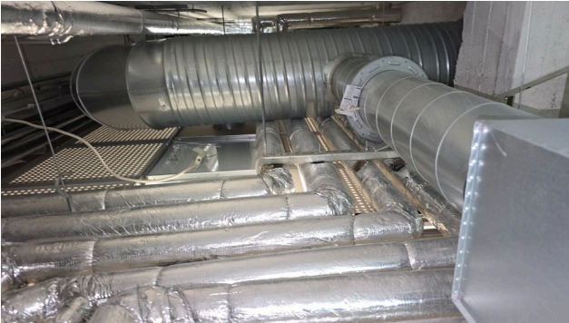
Käytävän putkieristeissä villoja näkyvillä
