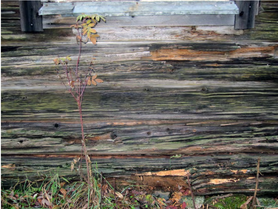
Kuva 12. Lahovaurioita kaakon puoleisen päädyn hirsissä ikkunan alapuolisella osalla.
