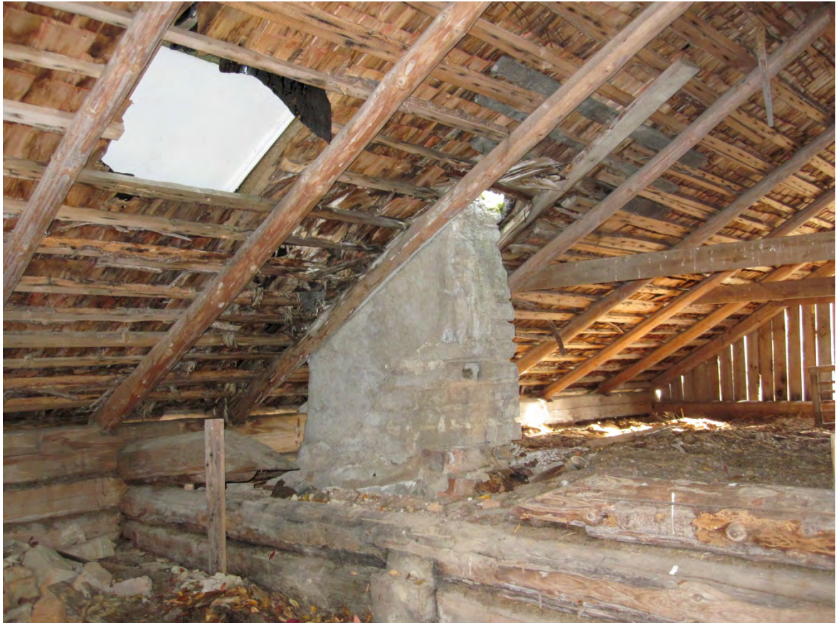
Kuva 10. Vesikaton vuotokohtia ja ullakkorakenteita.
