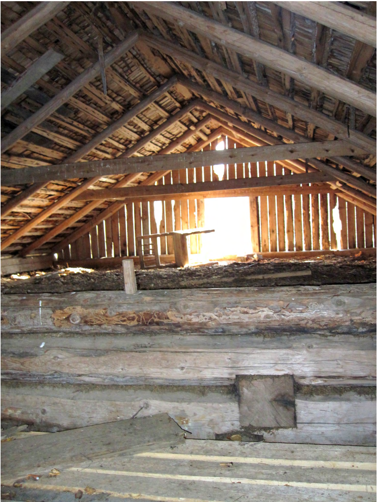
Kuva 11. Rakennuksen ullakkoa. Oikealla etualalla näkyy tuvan toisen kattoa kannattavan pyöröhirren huolellinen sovitus tuvan ja kamarin väliseinärakenteeseen. Yläpohjan eristeenä on turvetta ja sammalta. Paikallisista vesivaurioista huolimatta ullakkorakenteet näyttävät suhteellisen hyväkuntoisilta. Hyvin tuulettuva rakenne on päässyt kuivumaan.
