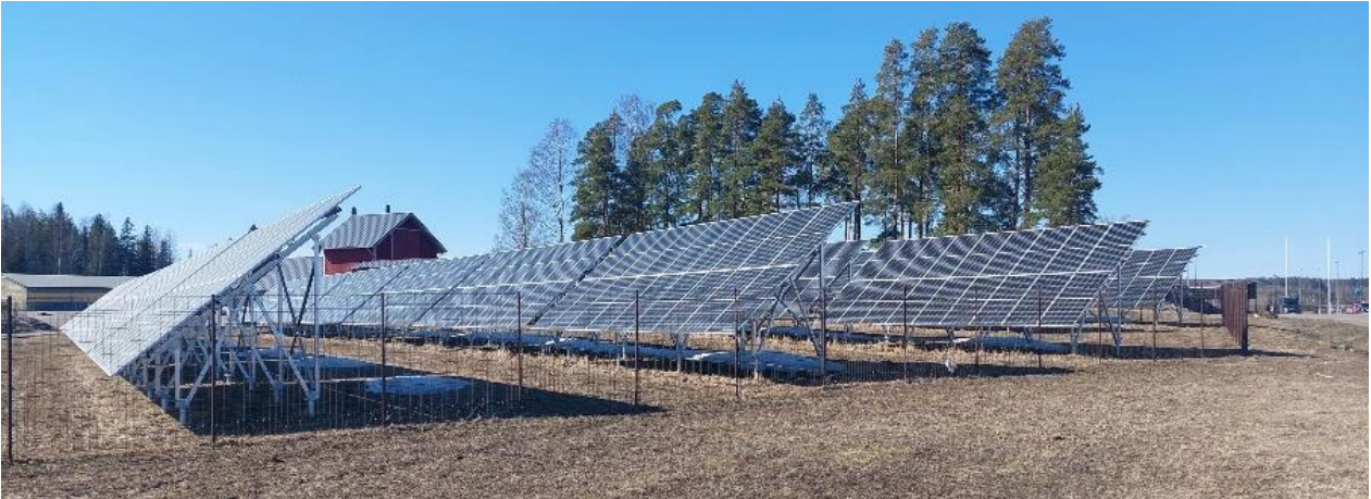
Kuva 13. Aurinkopaneelikenttä (Lähde: Solmar Consulting)
